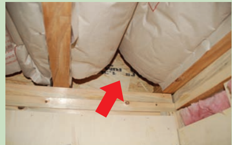
사진 1: 외기와 접한 2층 바닥의 끝막이장선 부위(붉은색 화살표)의 잘못 된 시공사례
